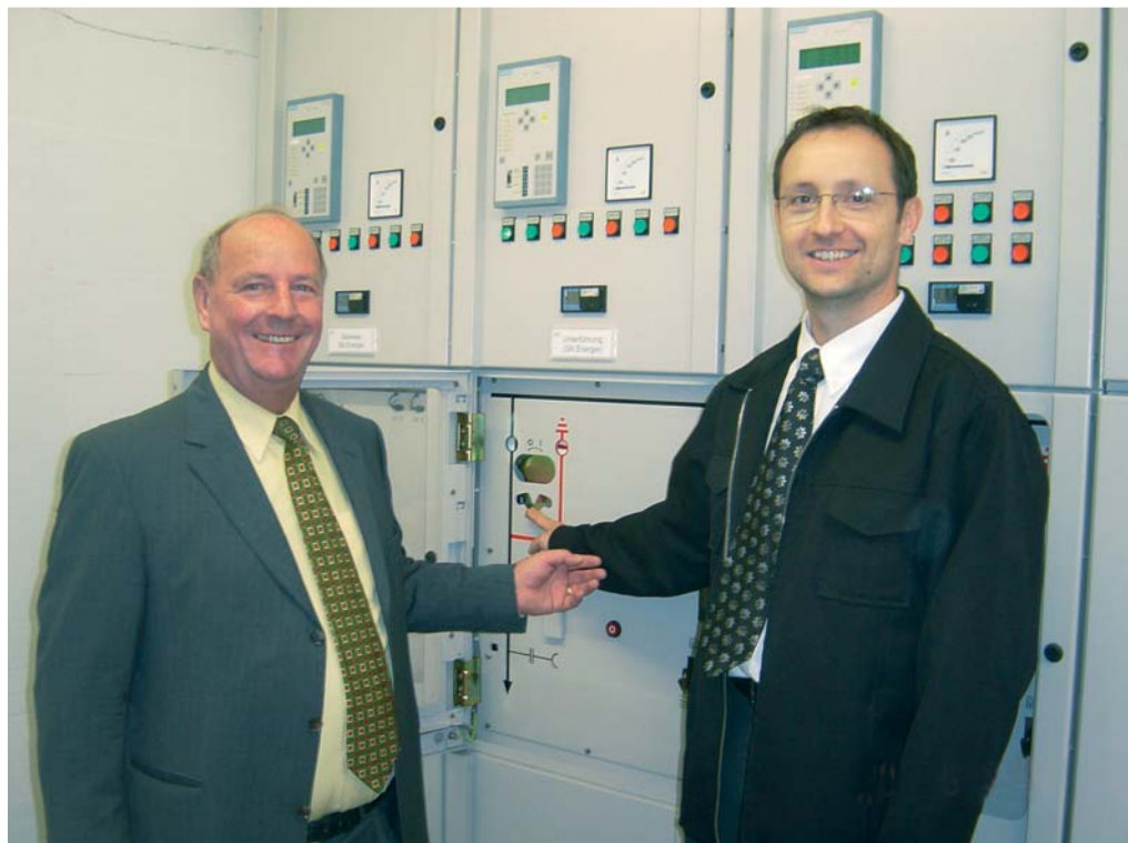
Der Verwaltungsratspräsident des EW Romanshorns, Dr. Fridolin Rüegge (links), lässt sich von Joh van der Bie, Bereichsleiter Energie, die neuen Installationen erklären.
